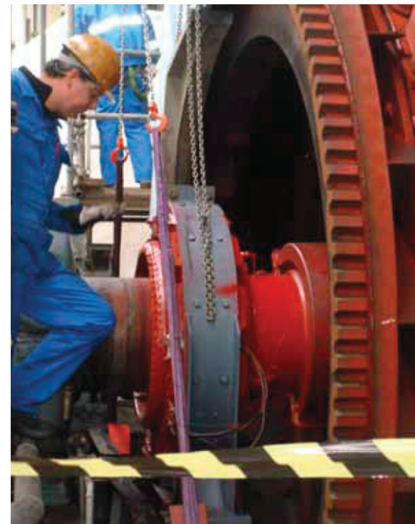
Kristof Decuyper bekijkt het schuiven van de stator over de rotor.
